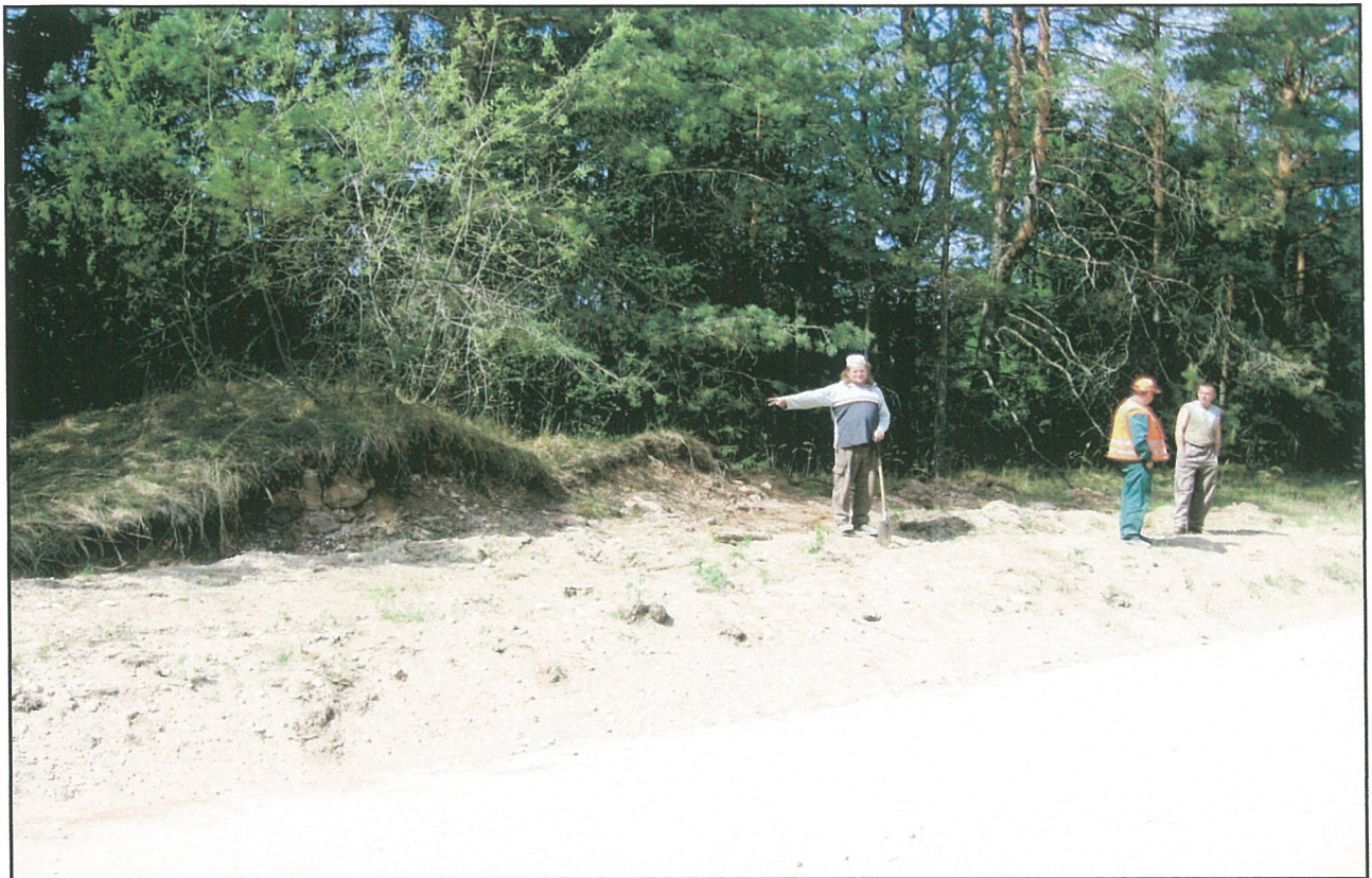
Pav. 12. Kelio darbai ties Liūlinės I pilkapynu [A1083P]. Vakarinė kelio pusė (ruožas į šiaurę nuo žvyrkelio ir pervažos kelio sankryžos). Taisant kelio griovį apardytas žemių kauburys pasirodė beesantis XIX a. nedidelio mūrinio statinio liekanomis. Fotografuota iš PR pusės.
