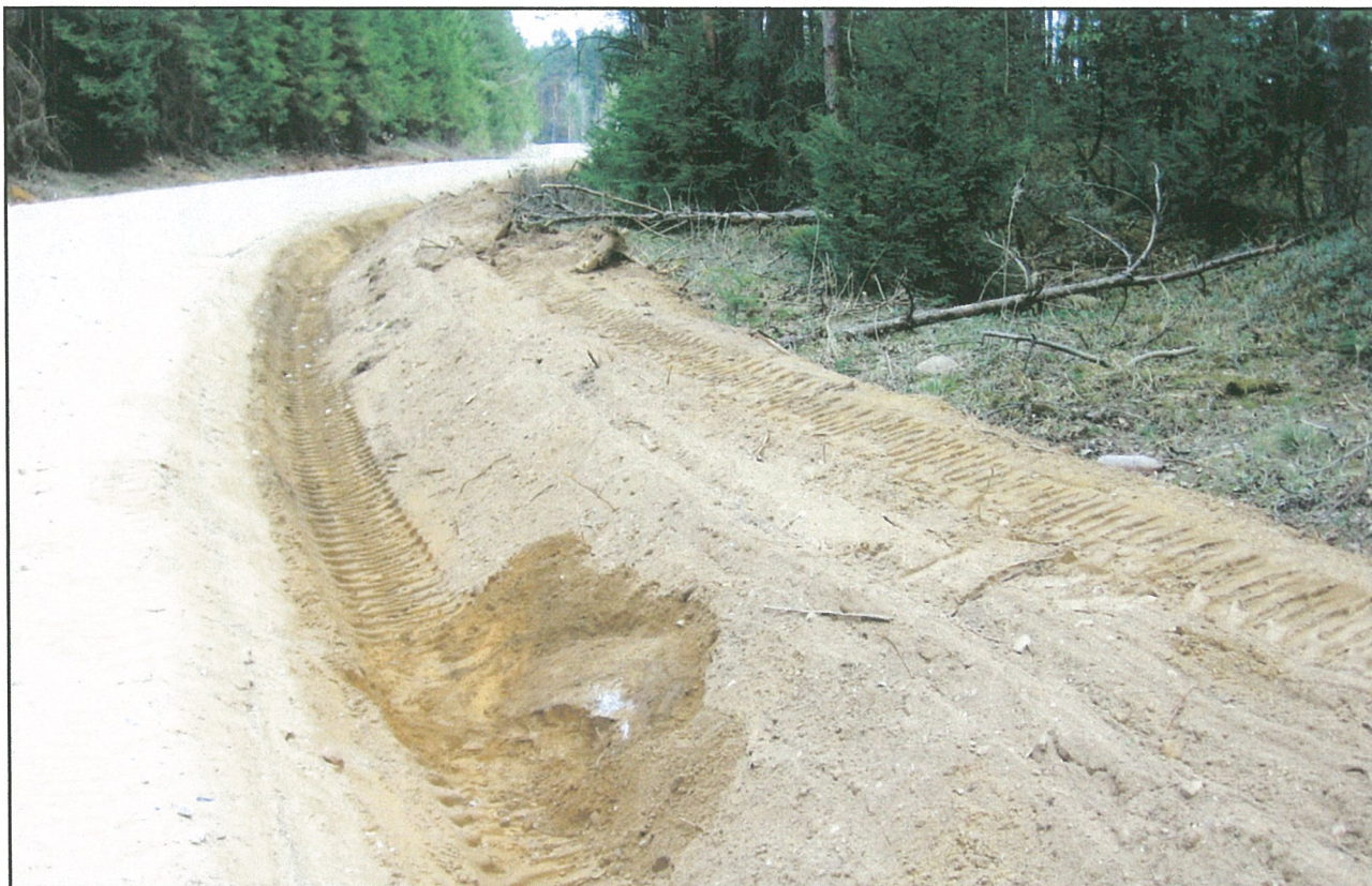
Pav. 8. Kelio darbai Sudotos I pilkapyne [A1118P]. Rytinė kelio pusė (ruožas į šiaurę prieš pat žvyrkelio vingį). Kelio griovyje atsidenęs masyvus riedulys yra iš pilkapiro vainiko. Fotografuota iš P pusės.
