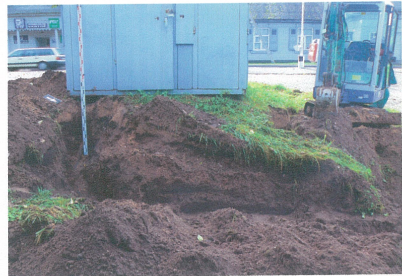
foto 24. Tranšėjos fragmentas prie transformatorinės Vydūno g. Foto iš R. Nuotr R. Šiaulinsko.
