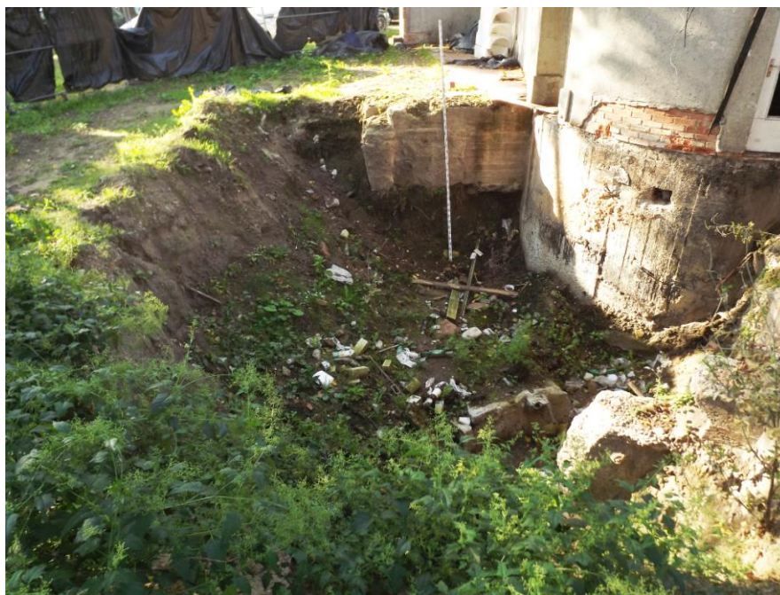
Fot. 1. 2011-12 iškasta duobė sklype Pylimo g. 7A, bendras vaizdas prieš žvalgymus, vaizdas nuo Š
