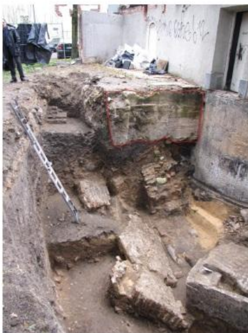
1. Sklypas Pylimo g. 7a. 2011 m. iškasta duobė, vaizdas po kraštinių atvalymo. Raudona linija pažymėti pietiniame pjūvyje esantys betoniniai pamatai. Vaizdas iš Š pusės.
