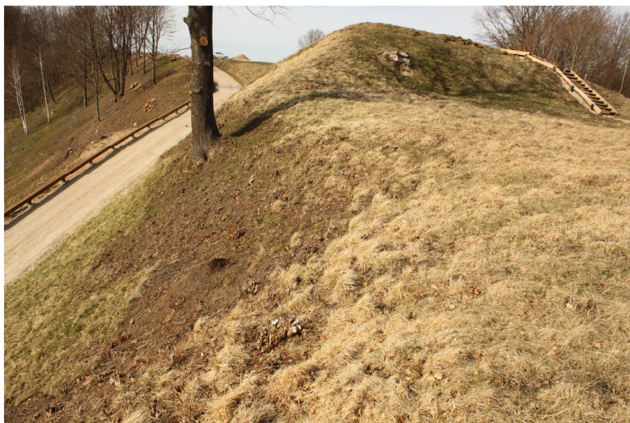
F 94. Panaikinta nuošliauža V piliakalnio šlaite, vaizdas iš P.
