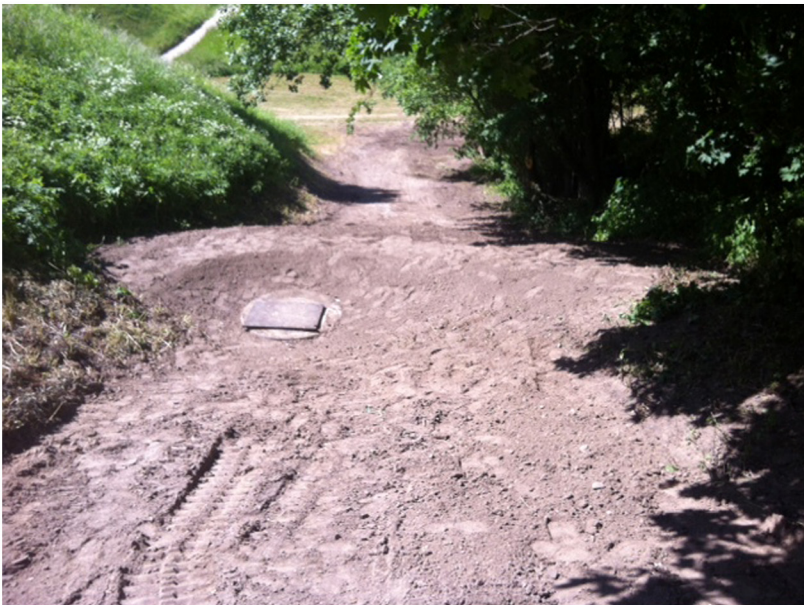
6. Trastos viršutinė bei apatinė atkarpos, naujai paklotas drenažinis vamzdis užpiltas atvežtiniu gruntu. Fotografuota iš rytų.
