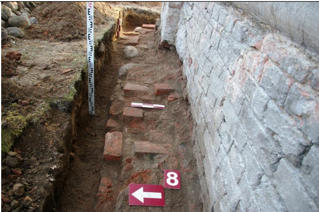
141 pav. Tranšėja Nr. 8. Pamato išplatinimas iš plytų ir akmenų. Vaizdas iš V.
