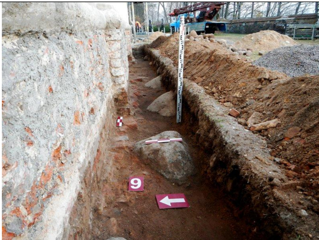
146 pav. Tranšėja Nr. 9. Pamato išplatinimas iš plytų ir akmenys ties piliastru. Vaizdas iš V.
