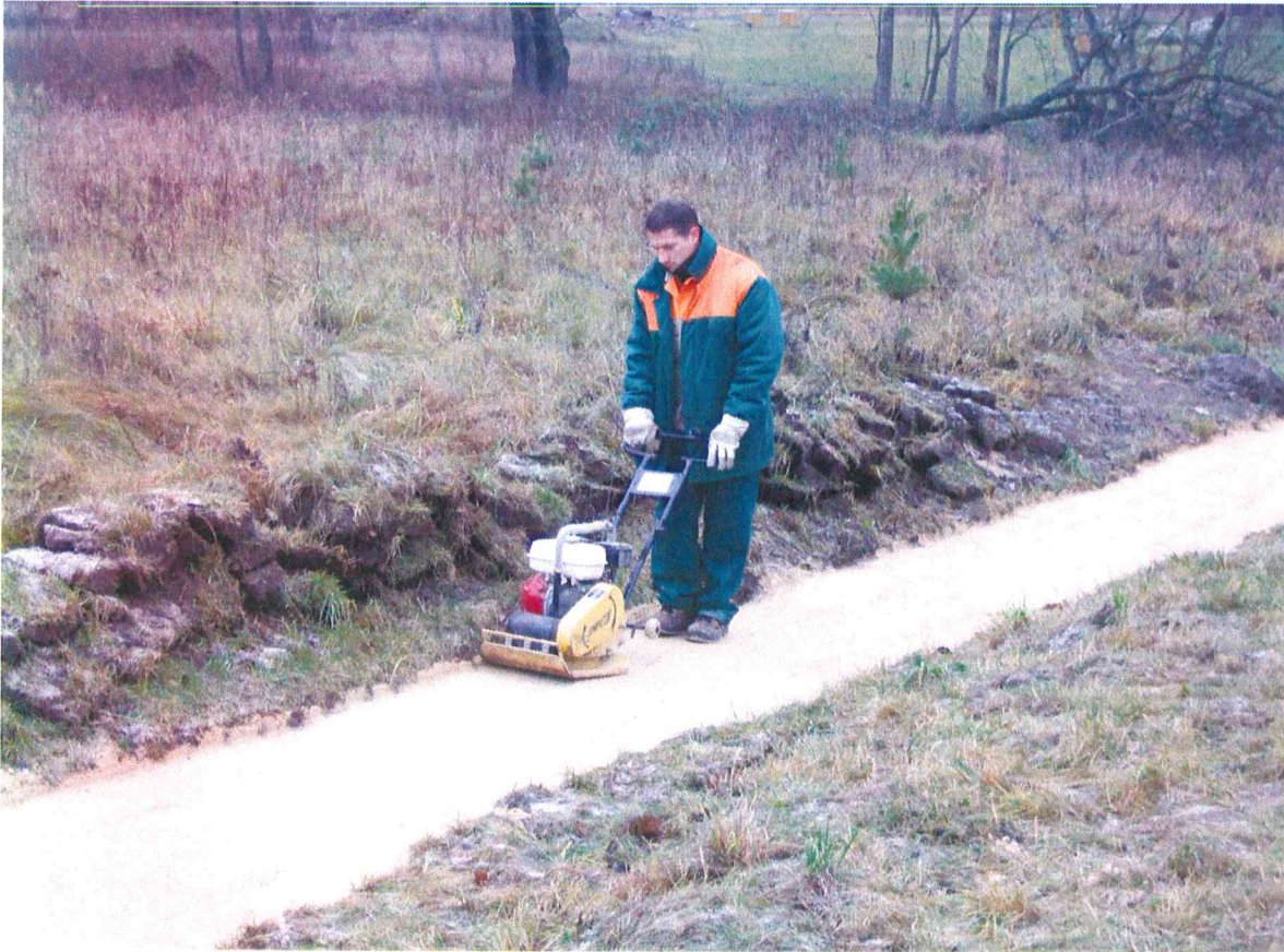
F 13. Gyvolių piliakalnio archeologiniai žvalgymai. Įrengiamas pėsčiųjų takas PR piliakalnio dalyje, atkarpa tarp tiltelio ir laiptų į piliakalnį. Užpilamas ir trombuojamas smėlio sluoksnis. Vaizdas iš ŠV.
