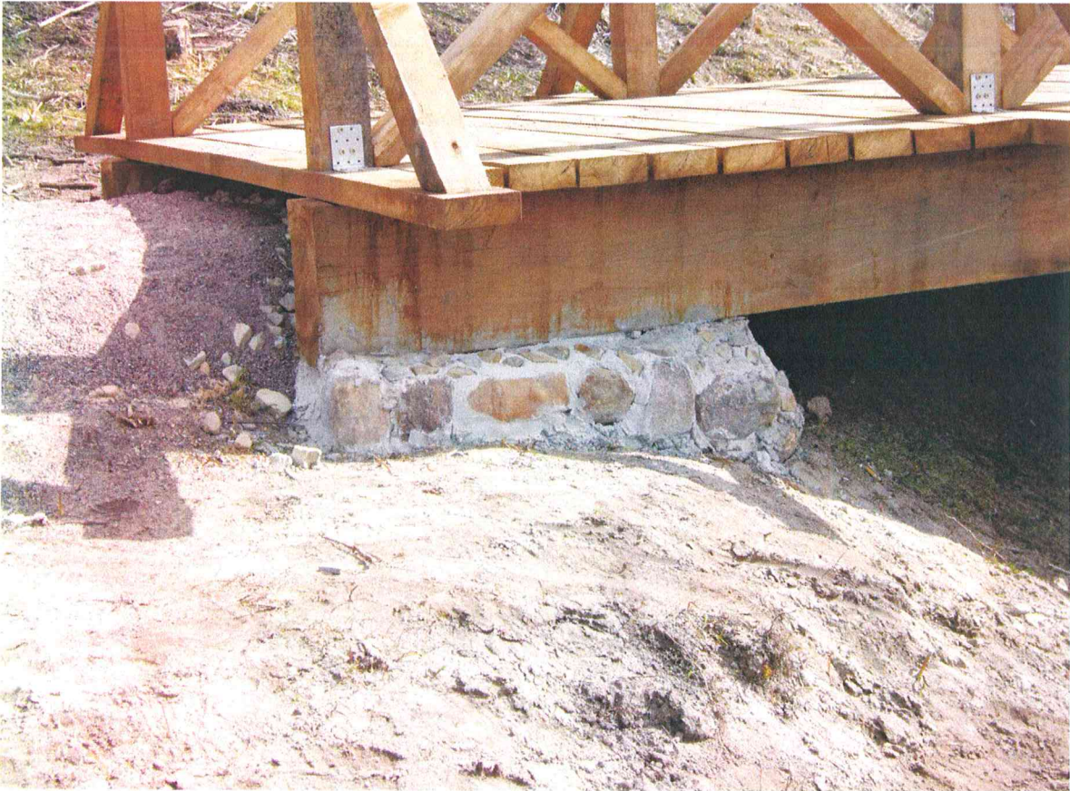
F 33. Gyvolių piliakalnio archeologiniai žvalgymai. Įrengta tiltelio per bevardį upelį piliakalnio Š dalyje atrama. Vaizdas iš ŠV.
