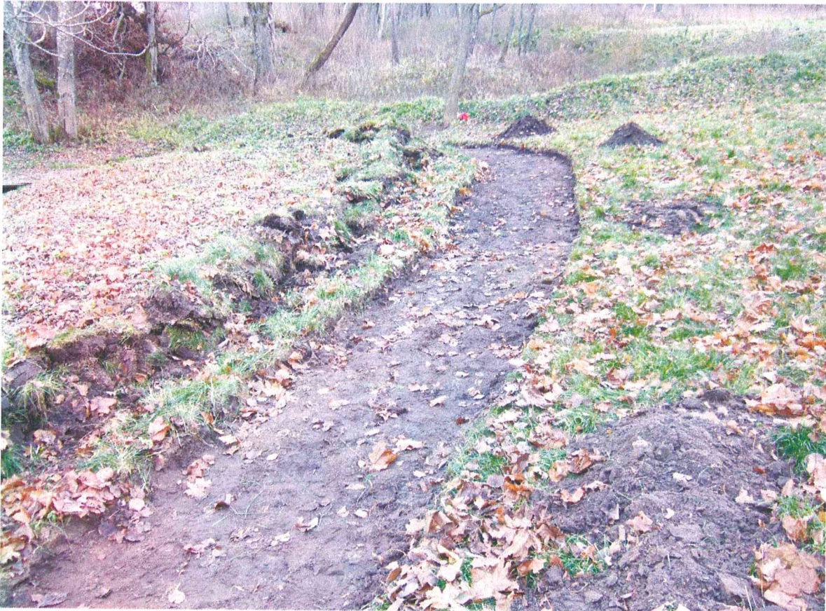
F 6. Gyvolių piliakalnio archeologiniai žvalgymai. Įrengiamas pėsčiųjų takas PR piliakalnio dalyje, atkarpa tarp tiltelio ir laiptų į piliakalnį. Nuimtas velėnos sluoksnis. Vaizdas iš ŠV.
