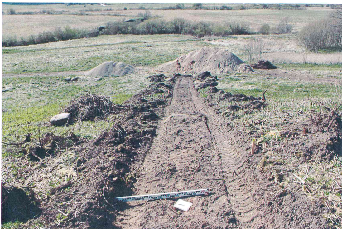
Fotografija Nr. 15 ŠV piliakalnio pašlaitėje įrenginėjamo terasuoto tako vietos vaizdas nuėmus velėną. Vaizdas iš V pusės.
