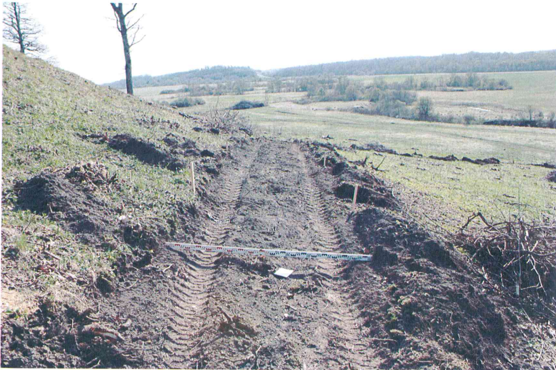
Fotografija Nr. 29 Didžiojo pylimo išorinėje dalyje įrenginėjamo pėsčiųjų tako vietos vaizdas nuėmus velėną. Vaizdas iš ŠR pusės.
