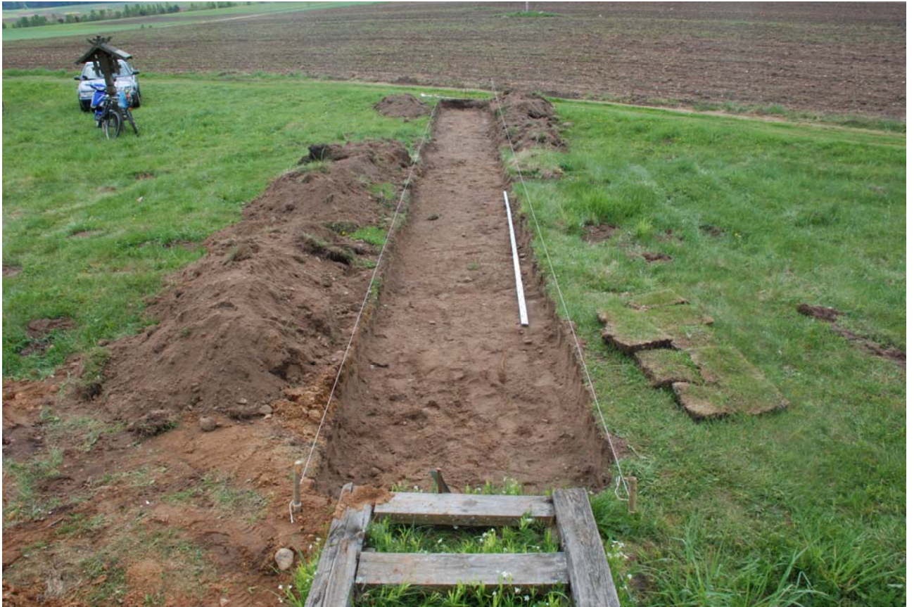
Pav. 46 Žvalgymai P piliakalnio papėdėje, įrengiamo tako vietoje. Vaizdas iš Š pusės.
