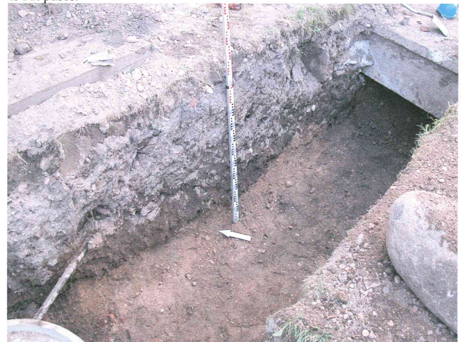
Nuotr. Nr.78. Lietaus nuotekynės trasa Nr.3. ŠR sienelēs pjūvio B-B1 fragmentas. Fotografuota iš V pusēs.
