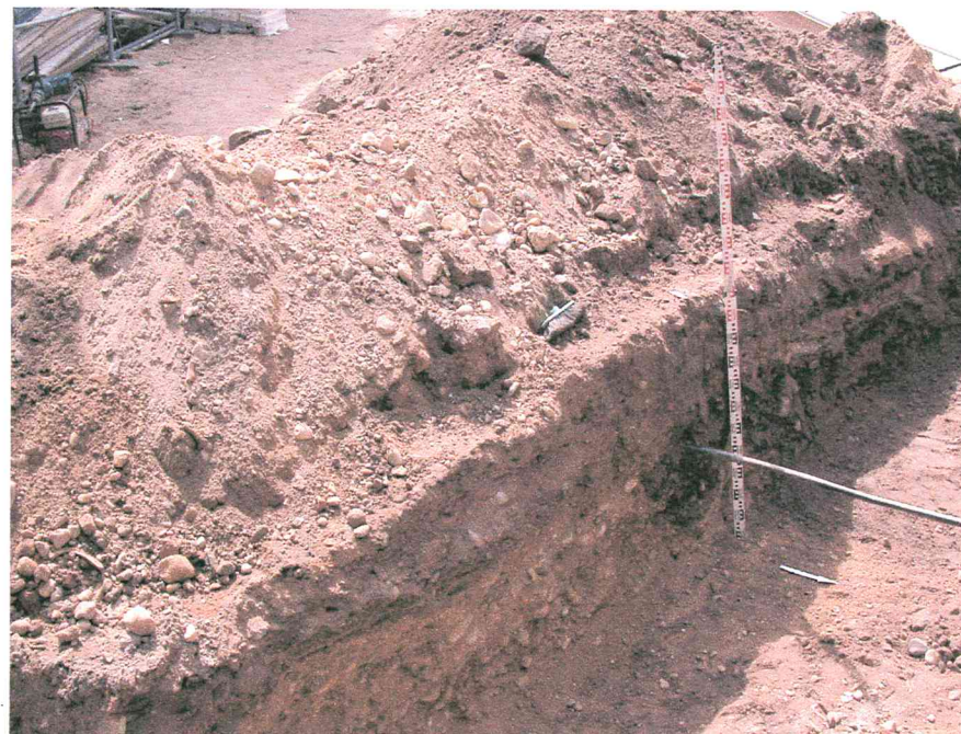
Nuotr. Nr.26. Perkasos Nr.2 išpjova (īvadas ī lietvamzdī). Išpjovos PV sienelēs pjūvis F-F1.
