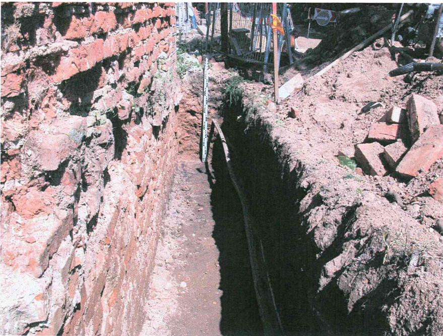
Nuotr. Nr.85. Perkasos Nr.5 kontrolinės juostos D PV sienelės pjūvis D-D1.
